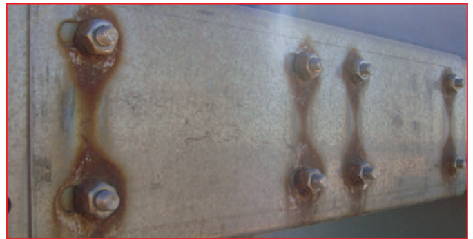
Exemplo de corrosão galvânica causada pelo acoplamento de porcas e parafusos de aço inoxidável numa placa de aço. Example of galvanic corrosion caused by combining stainless steel details on a steel plate.
